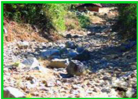
Vías de acceso en mal estado
